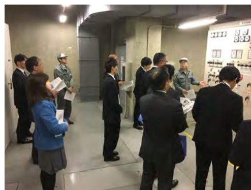
【平安通変電所の視察】
